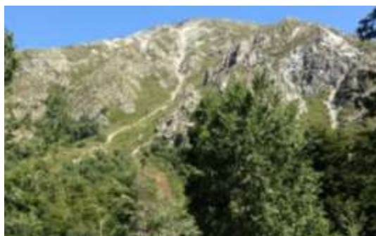
Figura N°26: Talud de desprendimiento activo
