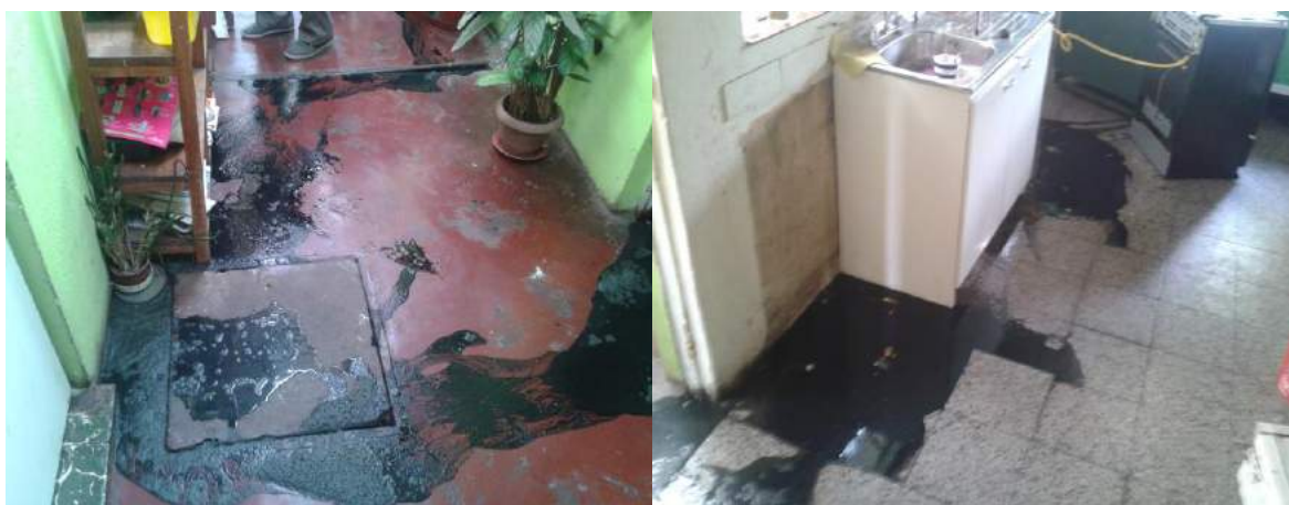
Figura 60. Ingreso de aguas servidas a interior de vivienda en la comuna de Concepción. Fuente: Unidad de mantenimiento preventivo, Essbio S.A.
