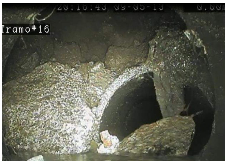
Figura 30. Colapso en colector de aguas servidas, materialidad Hormigón armado. Fuente: Plan de mantenimiento preventivo de redes Essbio S.A.
