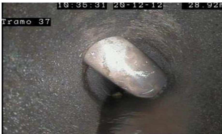
Figura 53. Incrustación en colector de unión domiciliaria penetrante. Fuente: Plan de mantenimiento preventivo de redes, Essbio S.A.
