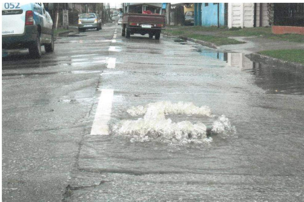
Figura 57. Afloramiento de aguas servidas en vía pública. Fuente: Departamento de redes, Essbio S.A.
