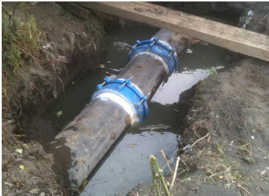
Figura 64. Falla por fatiga de material en impulsión de aguas servidas. Fuente: Departamento de redes, Essbio S.A.
