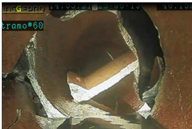
Figura 31. Colapso en colector de aguas servidas, materialidad Loza. Fuente: Plan de mantenimiento preventivo de redes Essbio S.A.
