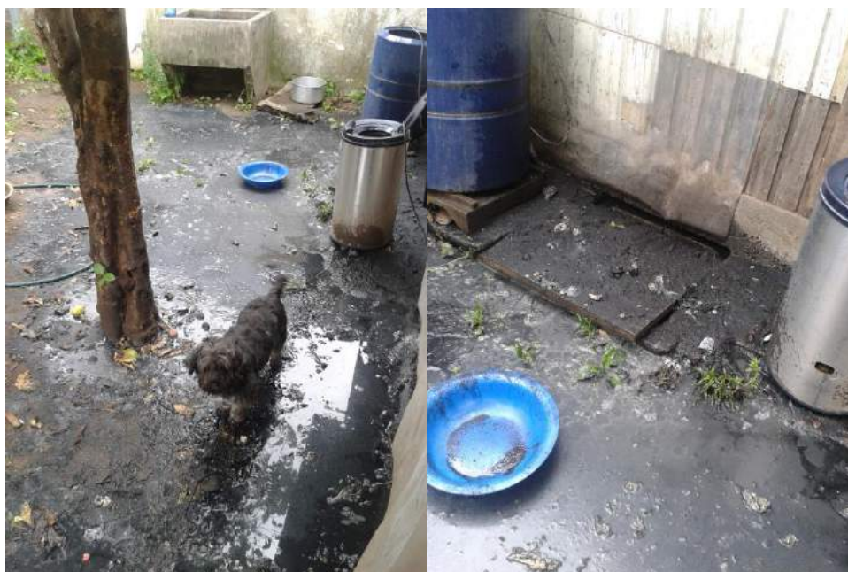
Figura 58. Ingreso de aguas servidas a interior de vivienda en la comuna de Concepción. Fuente: Unidad de mantenimiento preventivo, Essbio S.A.
