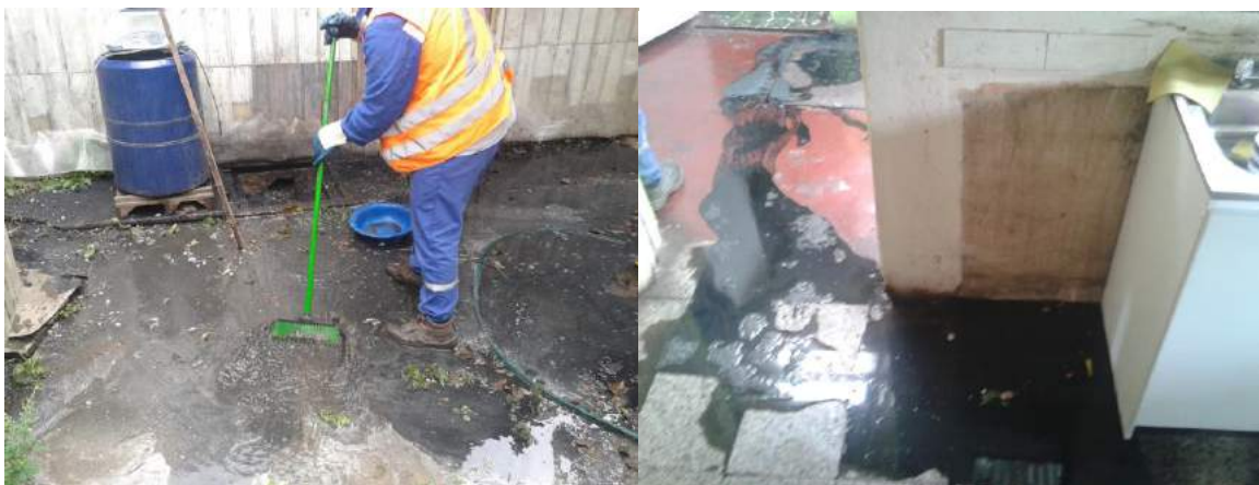
Figura 59. Ingreso de aguas servidas a interior de vivienda en la comuna de Concepción. Fuente: Unidad de mantenimiento preventivo, Essbio S.A.
