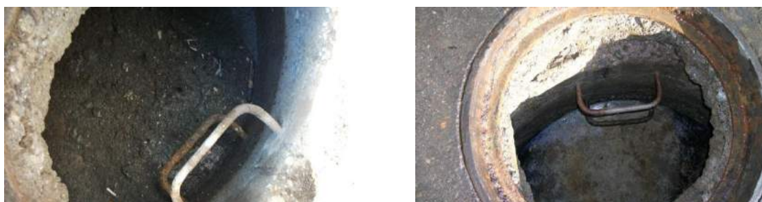
Figura 21. Cámaras de aguas servidas con embancamiento y nivel. Fuente: Plan de mantenimiento preventivo de redes Essbio S.A.
