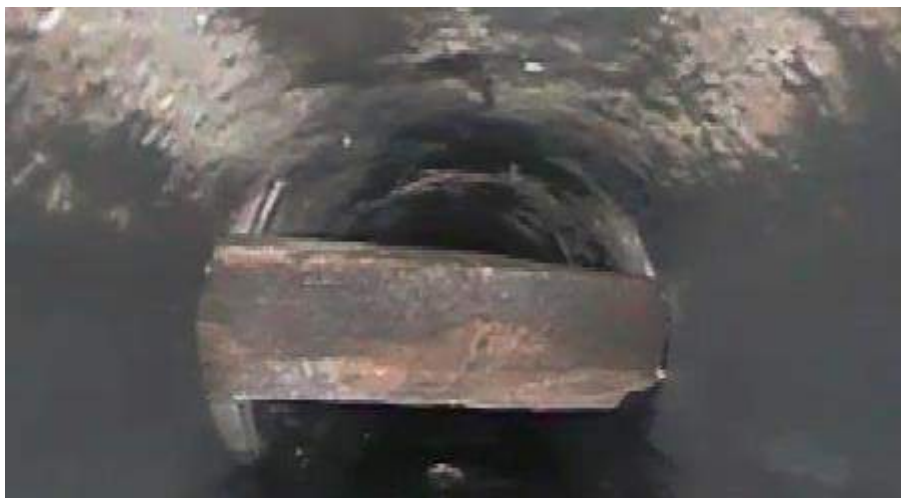
Figura 52. Incrustación en colector de elemento desde unión domiciliaria. Fuente: Plan de mantenimiento preventivo de redes, Essbio S.A.
