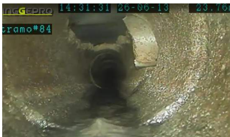
Figura 32. Colapso en colector de aguas servidas, materialidad Hormigon armado. Fuente: Plan de mantenimiento preventivo de redes Essbio S.A.
