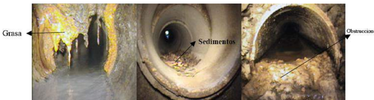
Figura 20. Problemas comunes en colectores de aguas servidas. Fuente: Plan de mantenimiento preventivo de redes Essbio S.A.
