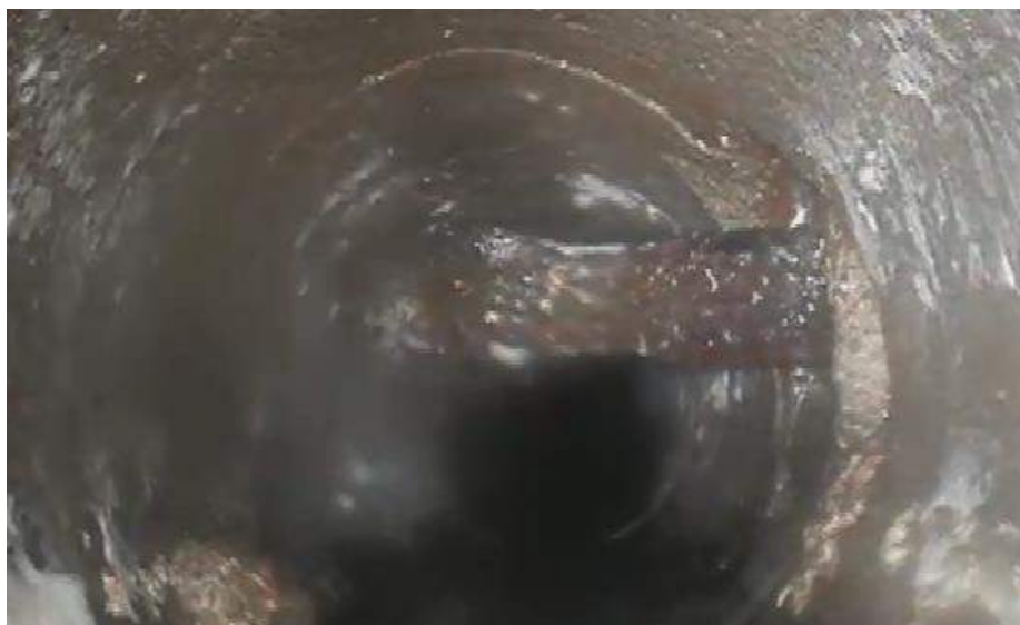
Figura 55. Incrustación en colector de elemento desde unión domiciliaria. Fuente: Plan de mantenimiento preventivo de redes, Essbio S.A.
