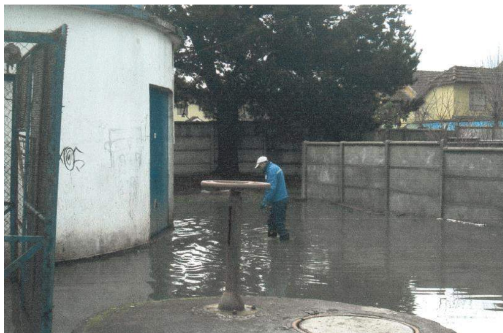
Figura 56. Colapso en planta elevadora de aguas servidas. Fuente: Departamento de redes, Essbio S.A.
