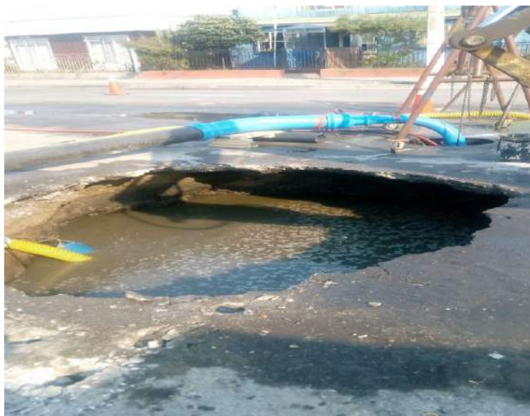
Figura 65. Rotura por colapso de material en colector de aguas servidas. Fuente: Departamento de redes, Essbio S.A.
