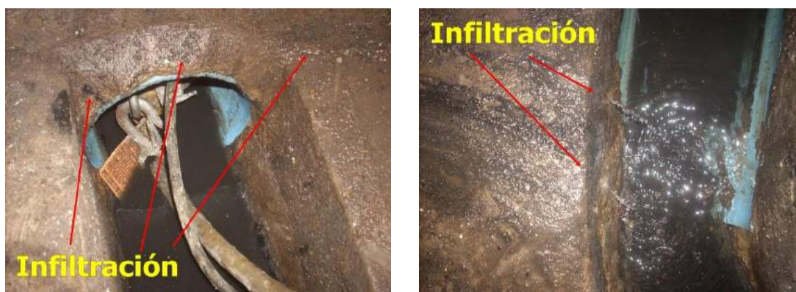
Figura 61. Infiltración en cámara de aguas servidas. Fuente: Unidad de infiltración, Essbio S.A.
