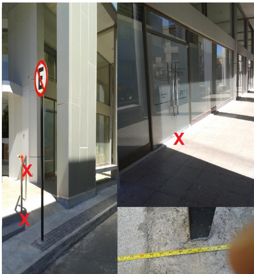
Imagen Nº 18: ·Ejemplo Nº 2 Errores de la Accesibilidad (Rampa)
