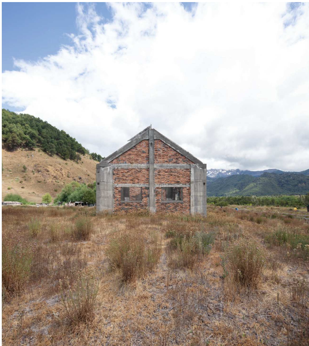
FIG. 89 Ruinas de la Estación de Sierra Nevada en el valle de Lonquimay. Fuente: Elaboración propia.
